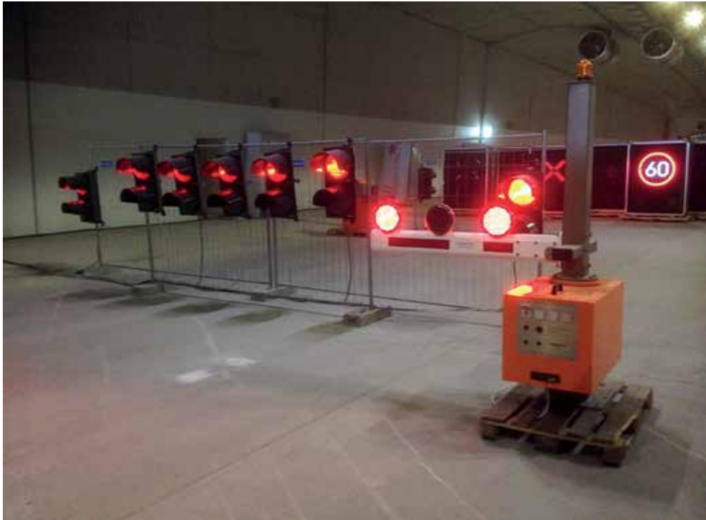
Versuchsaufbau der beschleunigten Inbetriebnahme in der Tunnelröhre
